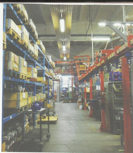
Il capannone di Bronzoni Motori Elettrici; in alto le termostrisce per il riscaldamento
